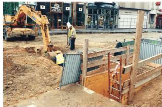
Fig. 4 - Mantes-la-Jolie (Yvelines). Vue de la place de la République au moment de l'intervention archéologique. L'accès à la salle basse s'effectue grâce à l'échelle posée entre les parois blindées et les vestiges arasés de la tour sont remblayés. © C. Piozzoli (SRA Île-de-France).
